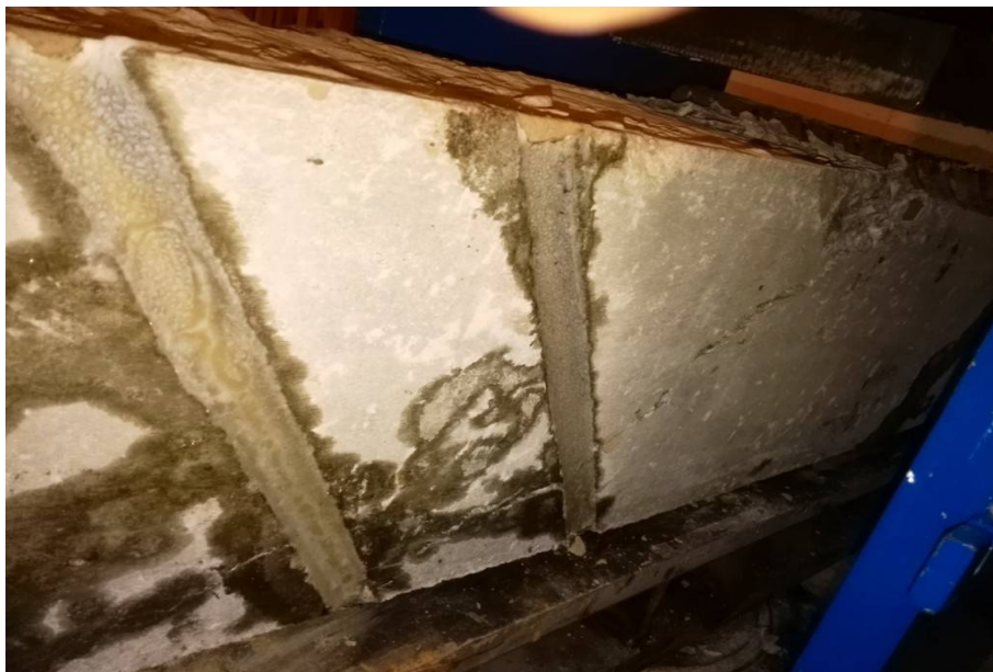
شکل ۳-۲ ترک خوردن و گسیختگی تیر NSMIL10
