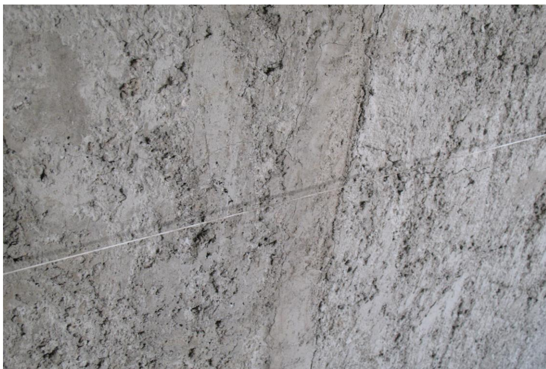
عکس شماره ۲۱: اجرای نامناسب سیمان کاری
