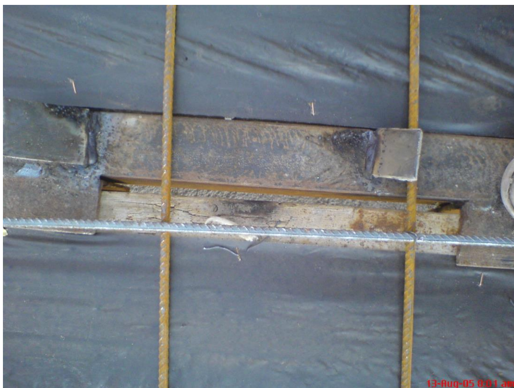
عکس شماره ۱۵: تیر معیوب در سقف
