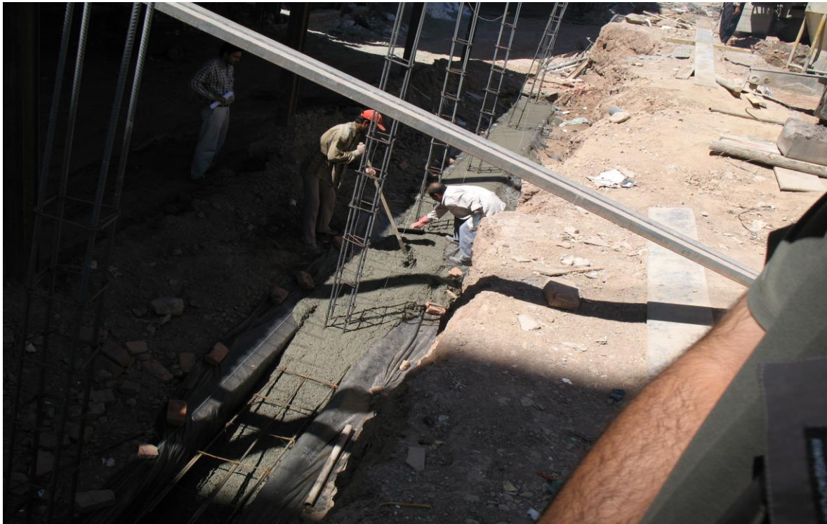
عکس شماره ۵: عدم استفاده از ویراتوردر بتن ریزی
